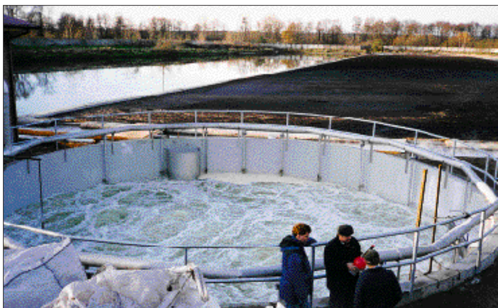
Nybyggt biologiskt reningssteg, enligt principen suspenderad biofilm, som ett försteg till befintlig aktivslamanläggning. Rasio Flootek är leverantör.
